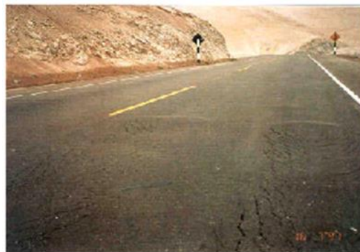
FOTO N° 4 Ondulación y corrimiento de la carpeta asfáltica.
