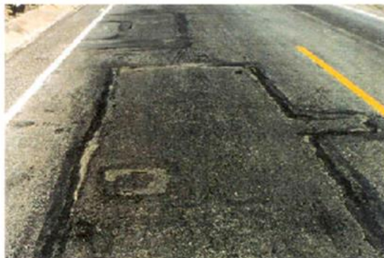
FOTO N° 5 Parchado mal conformado
