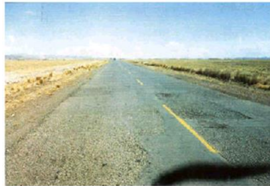
FOTO N° 6 Parchados con peladura o desgaste superficial.
