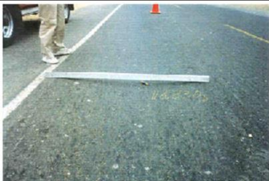
FOTO N° 3 Ahuellamiento severo medido con una regla de aluminio de 1,20 m de longitud y la depresión con una cinta métrica.
